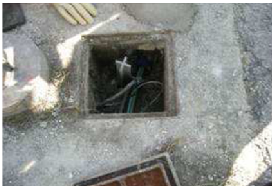
Fig.3: Pozzetto della pubblica illuminazione aperto con il transitò all'interno dei 2 minitubi di TI.
