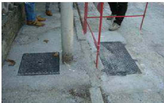
Fig. 1: I pozzetti che ospitano le infrastrutture degli Enti e di TI debbono necessariamente essere separati. Nella Foto il pozzetto della pubblica illuminazione (a sx) e il pozzetto di TI (a dx).
