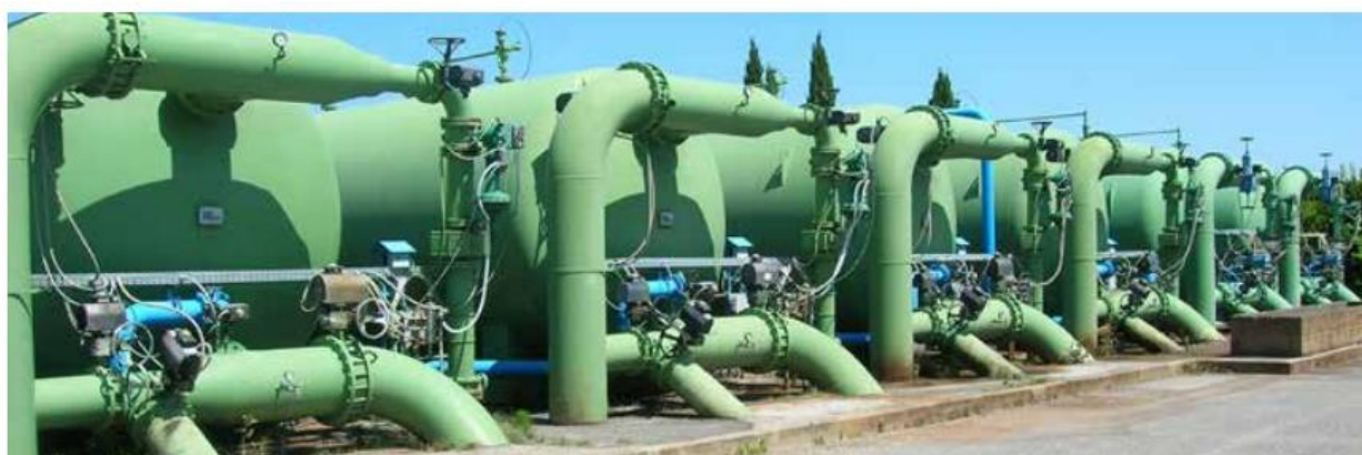
Figura 31 Impianto di potabilizzazione di Mortaiolo, Collesalveti (Fonte: BSA 2018 ASA spa)
